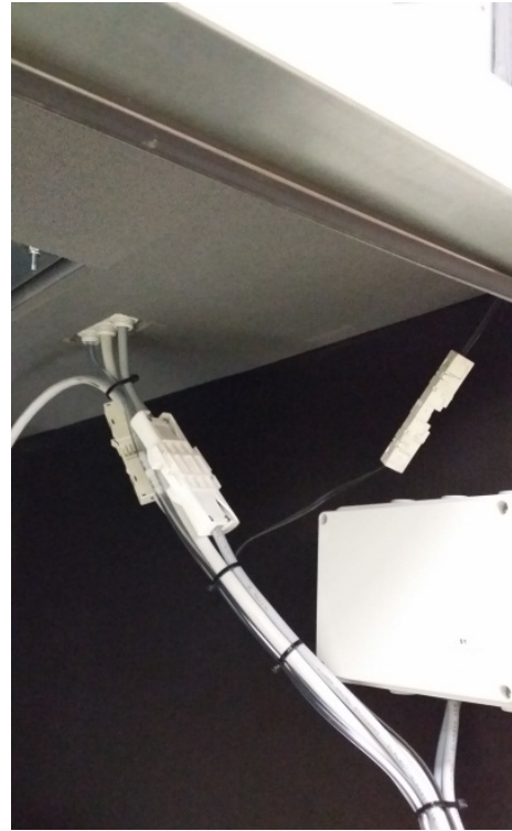
Kuva 8: kaapelit ja letkut
